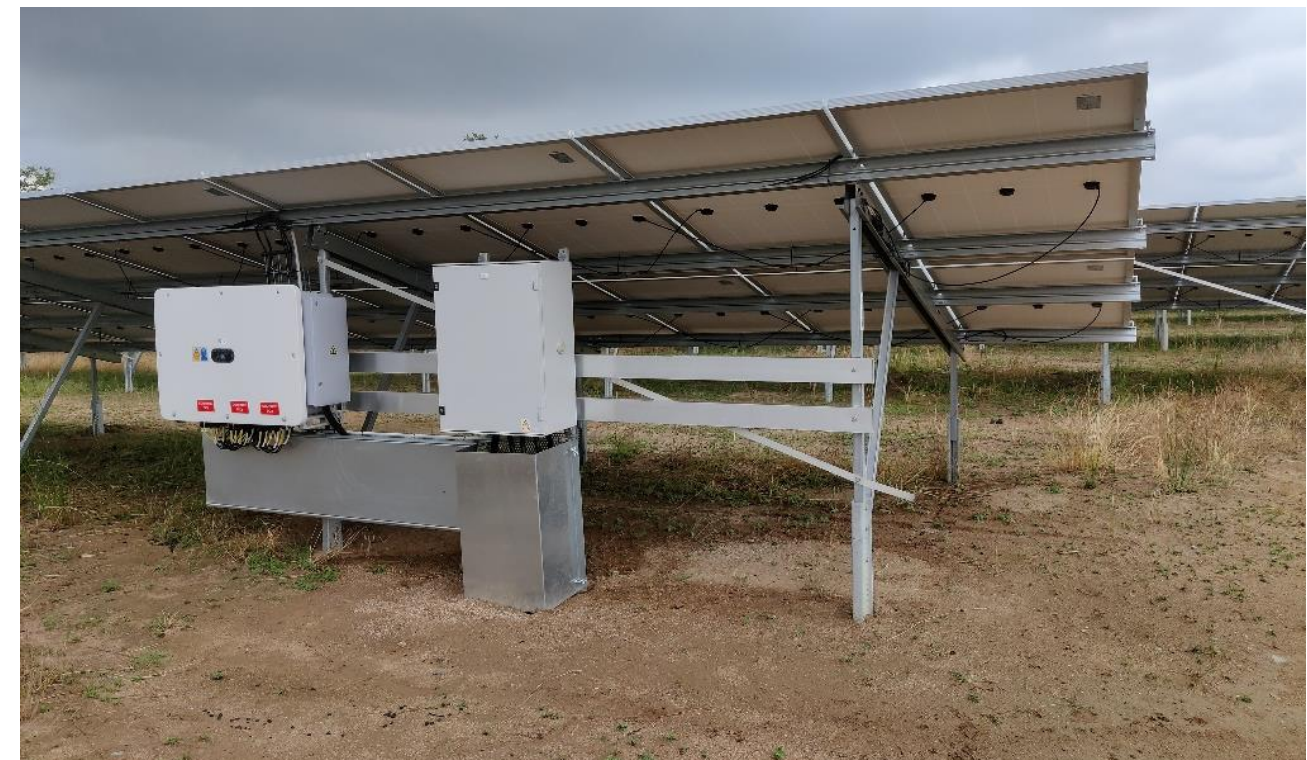
Exemple de mise en place des onduleurs sur les structures – source EnergieKontor
